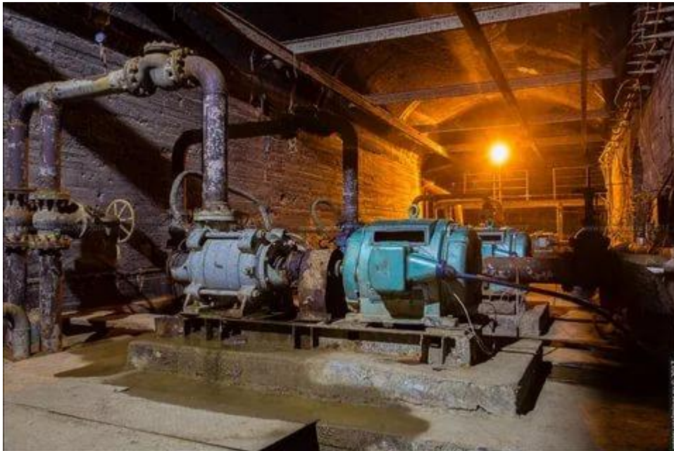
Рис. 1.1.2 Камера головної водовідливної установки шахти
